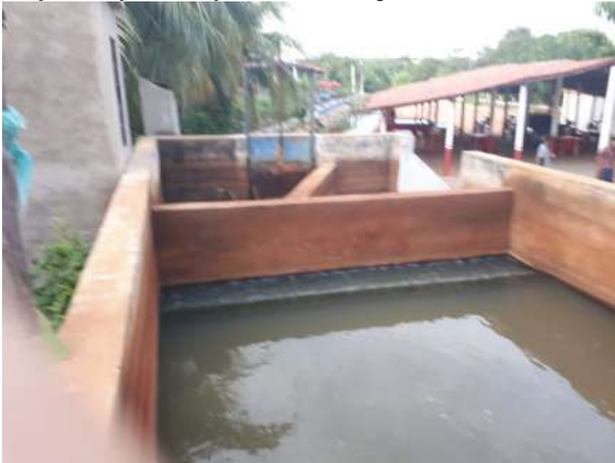
Figura 55 - Poço de Sucção da Estação Elevatória de Água Bruta
