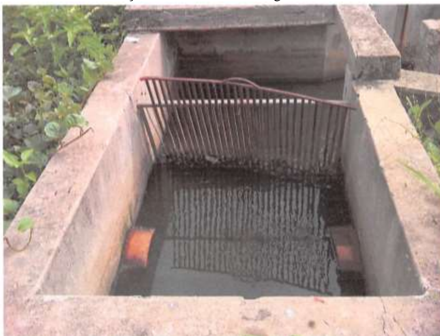
Figura 60 - Grades de uma Estação de Tratamento de esgotos
