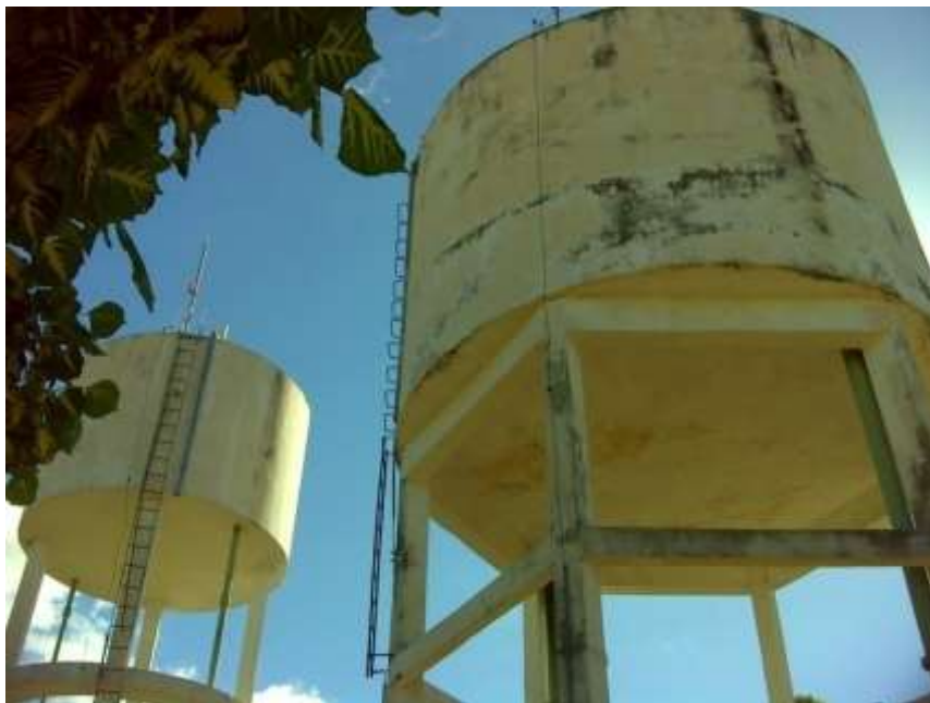
Figura 46 - Reservatórios elevados de 150 e 100m 3
