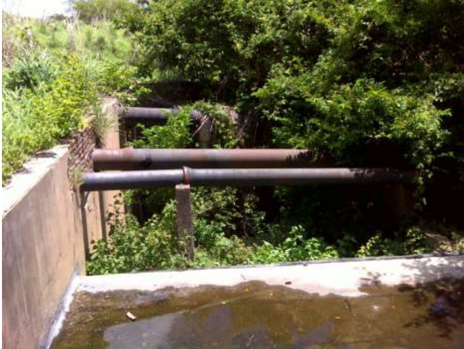
Figura 41 - Trecho por recalque na saída da Elevatória de Água Tratada
