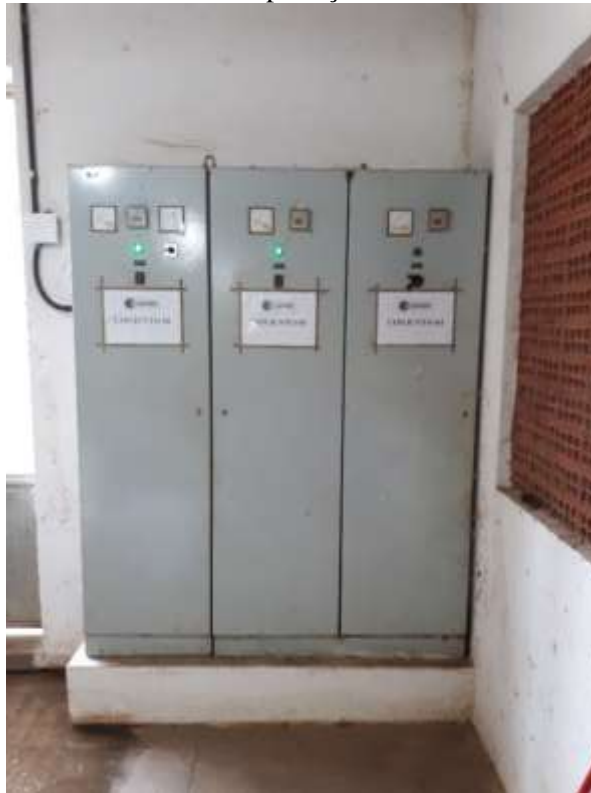
Figura 40 - Quadros elétricos de comando e proteção
