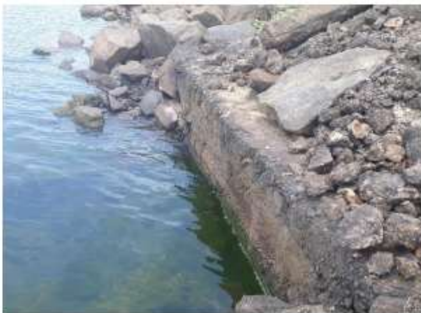
Figura 51 - Tomada de água/caixa de captação
