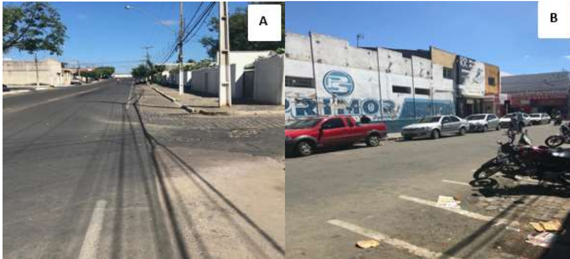
Figura 75 - Vias sem a presença de sarjetas: (A) Rua Arsênio Rolim Araruna e (B) Praça Coronel Emídio Cartaxo
