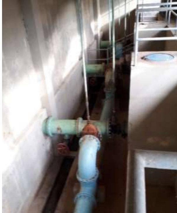
Figura 31 - Galeria de manobras de uma Estação de Tratamento de Água
