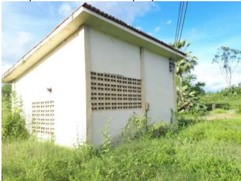
Figura 62 - Casa de quadro elétrico de comando e proteção
