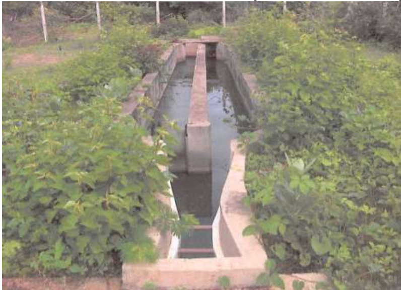
Figura 61 - Caixa de areia e Calha Parshall de uma Estação de Tratamento de Esgotos
