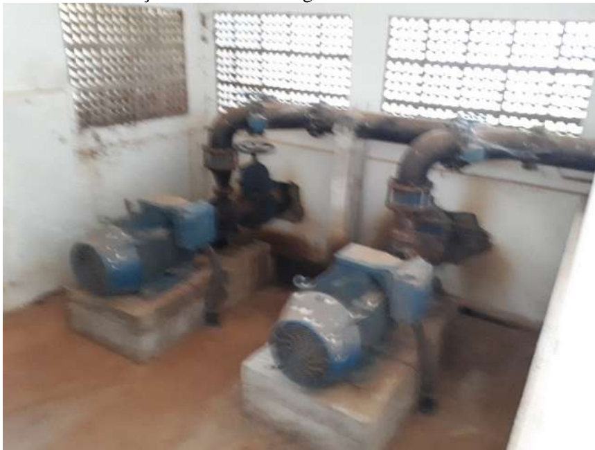
Figura 56 - Bombas da Estação Elevatória de Água Bruta
