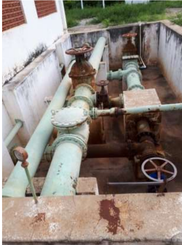
Figura 39 - Estação Elevatória de água tratada - válvulas e adutoras
