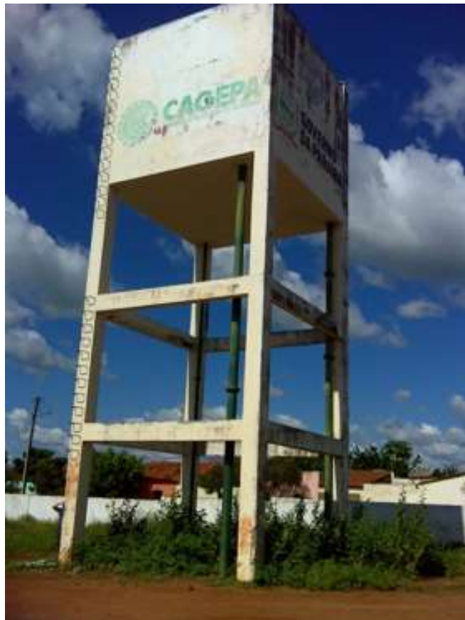
Figura 44 - Reservatório elevado de 100m 3
