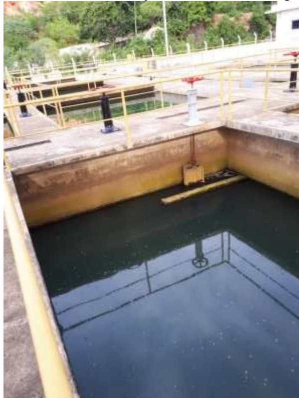
Figura 32 - Floculadores e filtros de uma Estação de Tratamento de Água
