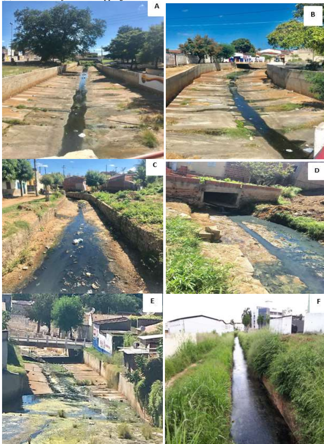
Figura 72 - Galeria de águas pluviais: (A) Rua Arsênio Rolim Araruna, (B) Avenida Comandante Vital Rolim, (C) Rua São José, (D) Rua Rafael Moreira Costa, (E) Rua Doutor Aprígio de Sá e (F) Lateral do Cajazeiras Shopping
