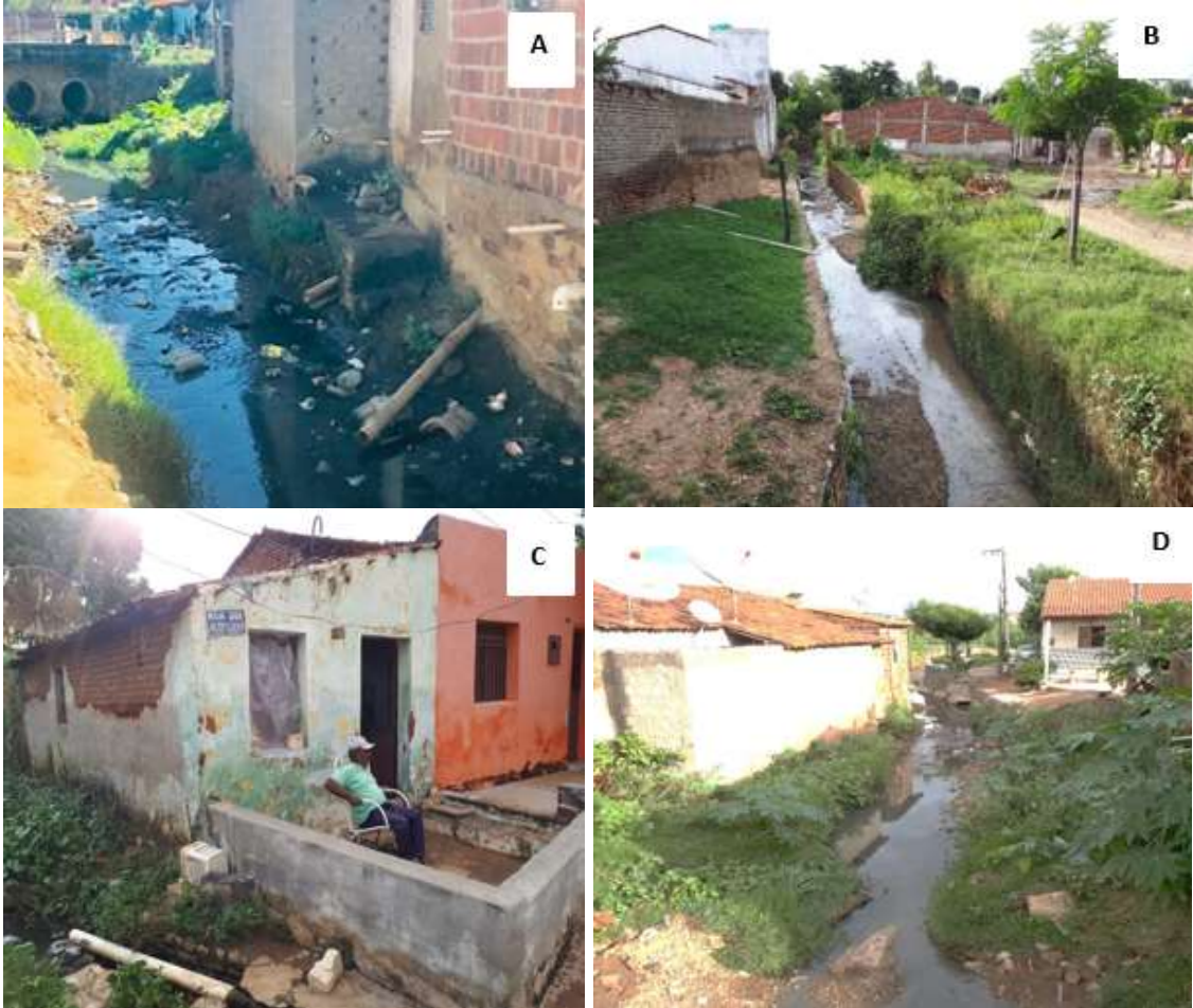
Figura 77 - Ligações clandestinas de esgoto no sistema de drenagem: (A) Rua Projetada, (B) Rua Pedro Revoltoso, (C) Rua João Pereira da Silva, (D) Rua São José
