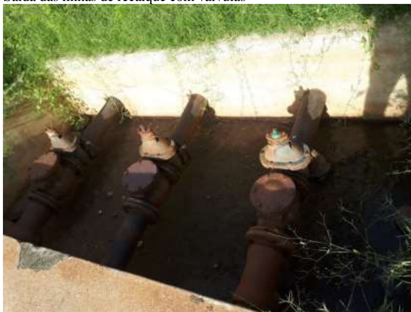
Figura 64 - Saída das linhas de recalque com válvulas
