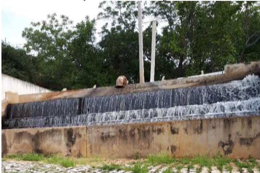
Figura 30 - Aerador de uma Estação de Tratamento de Água
